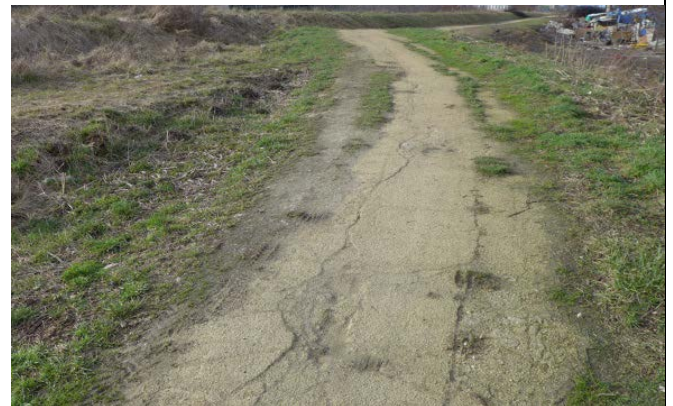
Ex 2 : voies verte de l'aqueduc de la Vanne, 9 années plus tard : la surface est dégradée et l'herbe gagne
